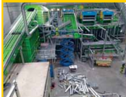
Implantation des machines de tri
